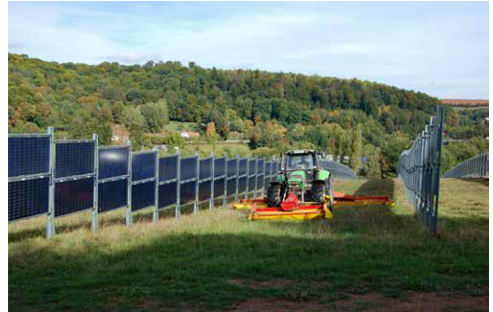
Quelle: Vertikal errichtete bifaziale Module im Solarpark in Eppelborn-Dirmingen, Saarland mit 2 MWp Leistung, errichtet von Next2Sun. © Next2Sun GmbH
